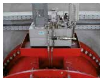
Wasserkraftwerk: Aggregat für Fallgewichtsklappe im Kühlwasserkreislauf
