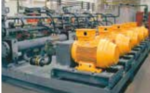
Pumpenstation für Bandwickelanlage
