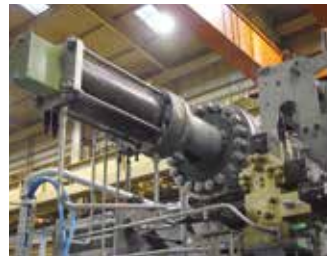
Schnellschlussventil als Schutz gegen Turbinen-Überdrehzahl
