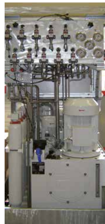
Windkraftanlage: Hydraulikaggregat für Bremsfunktion und Azimutverstellung
