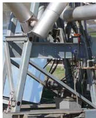
Sonnenwärmekraftwerk: Aggregat für Parabolspiegelverstellung
